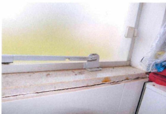
7.35. Desafixação do peitoril da janela do Depósito de Materiais de Limpeza – DML
