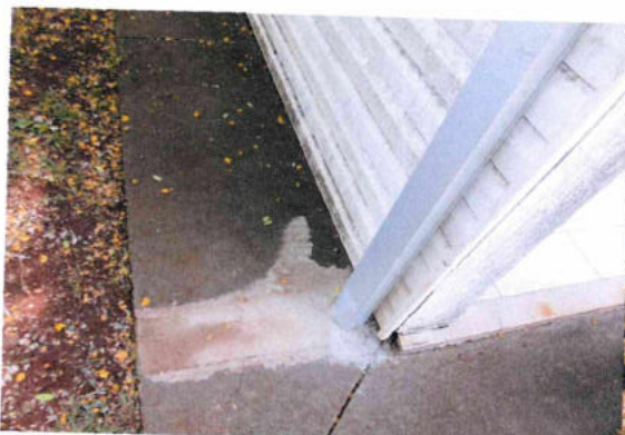
7.53. Condutores d'água pluvial instalados rente à Fachada Sul do imóvel.
