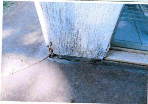
7.15. Rachadura no encontro da parede com a calçada perimetral na Fachada Oeste.
