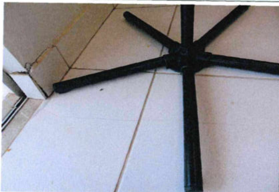
7.45. Fissuração próxima ao vão da porta de vidro no acesso principal pela Fachada Leste.
