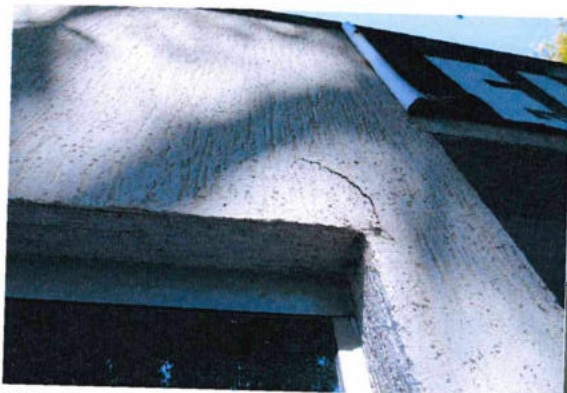
7.17. Rachadura junto ao canto superior do vão do fechamento em vidro na Fachada Oeste.
