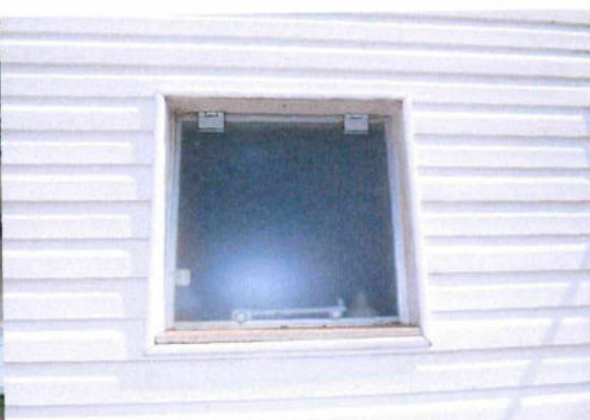
4.19. Janelas de vidro temperado mini-boreal, nos Lavabos e no Depósito de Material de Limpeza - DML.
