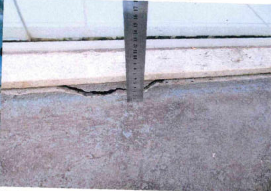
7.16. Rachadura no encontro da soleira do fechamento em vidro com a calçada na Fachada Oeste.
