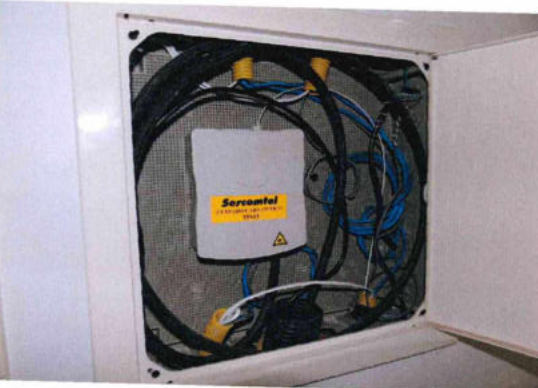
6.3. Quadro de Telefonia, instalado na Circulação.
