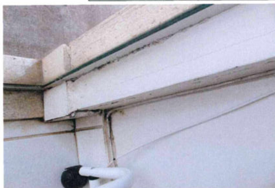
7.27. Trincas verticais nas paredes internas junto ao fechamento em vidro na Fachada Oeste.
