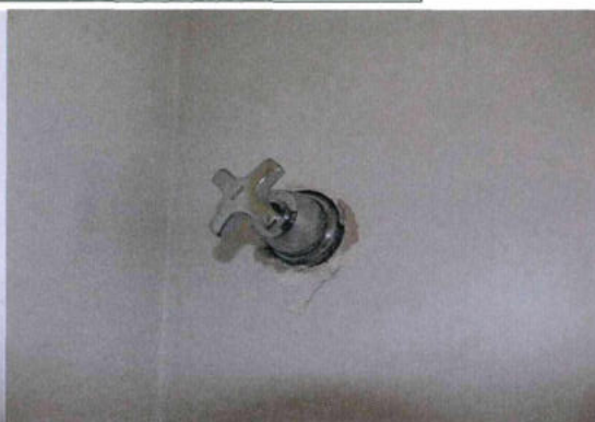
7.34. Ruína do revestimento e da pintura da parede no entorno do registro geral do Lavabo Feminino
