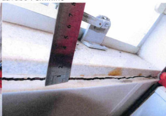
7.36. Desafixação do peitoril da janela do Depósito de Materiais de Limpeza – DML
