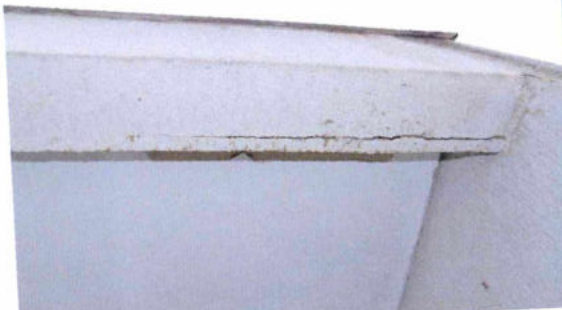
7.11. Trinca na face inferior da testeira do beiral na Fachada Leste.
