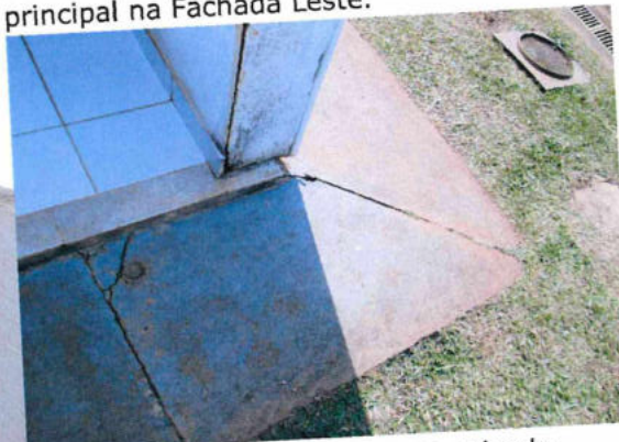
7.12. Trincas generalizadas na calçada perimetral em piso cimentado.
