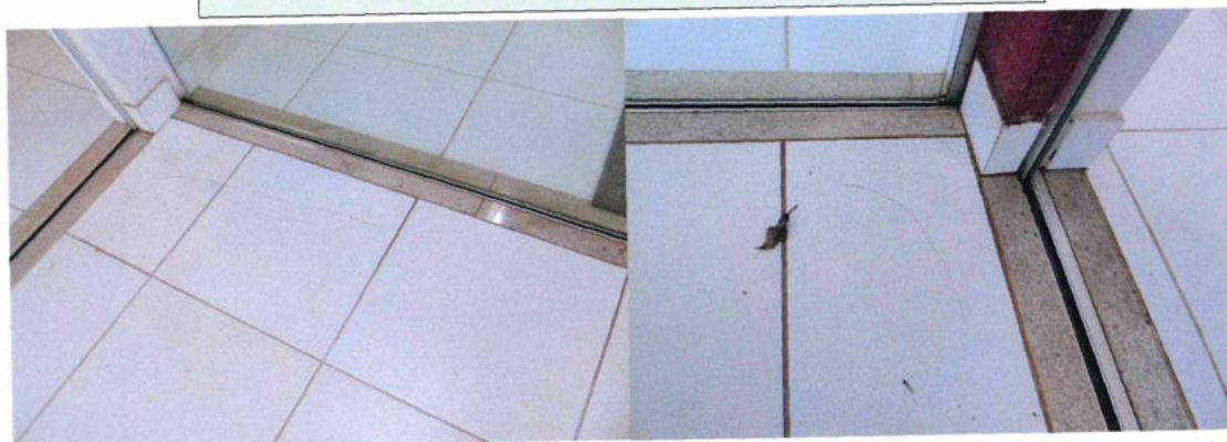
7.21. Fissuras no piso cerâmico da Varanda externa nas proximidades com as portas de vidro.
