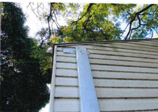
7.50. Condutores d'água pluvial instalados rente à Fachada Sul do imóvel.
