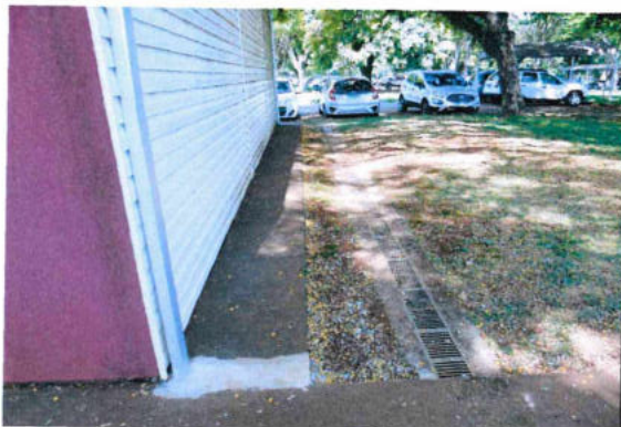
7.47. Condutores d'água pluvial instalados rente à Fachada Sul do imóvel.
