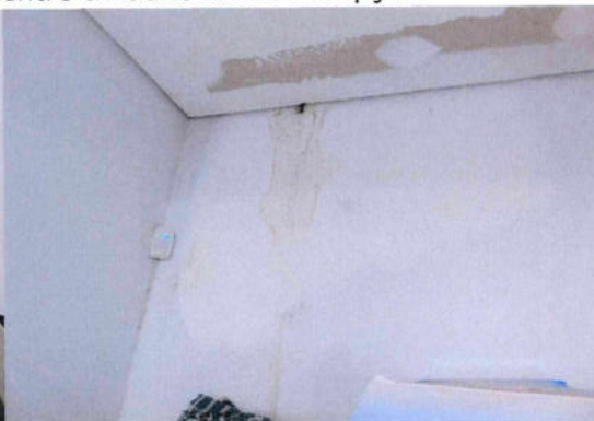
7.42. Marcas de infiltração e escoamento d'água no topo da parede, e no forro adjacente, na Recepção.
