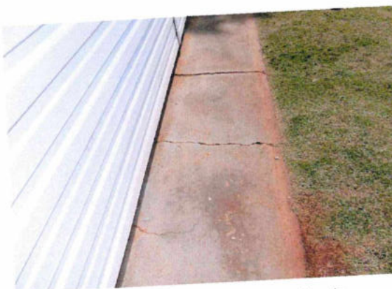
7.13. Trincas generalizadas na calçada perimetral em piso cimentado.
