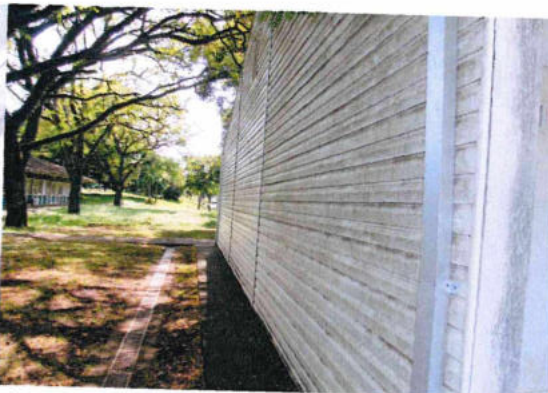
7.54. Condutores d'água pluvial instalados rente à Fachada Sul do imóvel.
