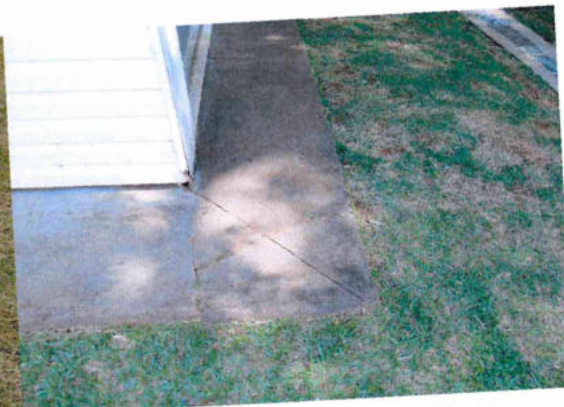
7.14. Trincas generalizadas na calçada perimetral em piso cimentado.
