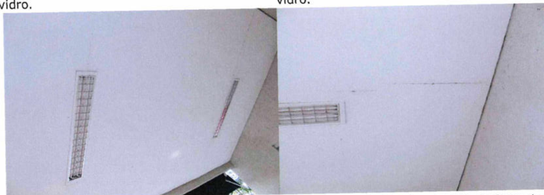
7.23. Marcas de deslocamento do forro de gesso acartonado na Varanda.
