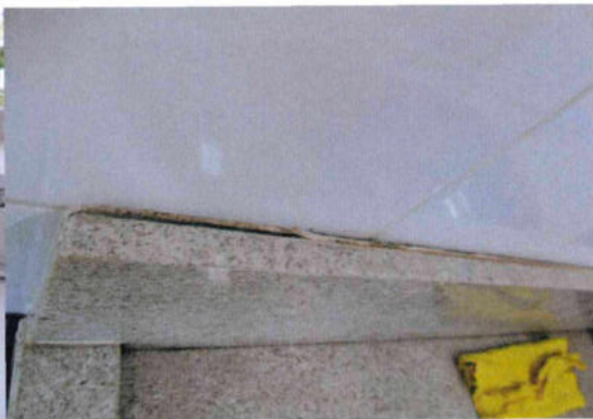
7.30. Descolamento generalizado do barrado em granito da bancada da Copa.
