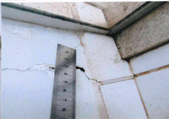
7.28. Fenda vertical na parede interna junto ao fechamento em vidro na Fachada Oeste.
