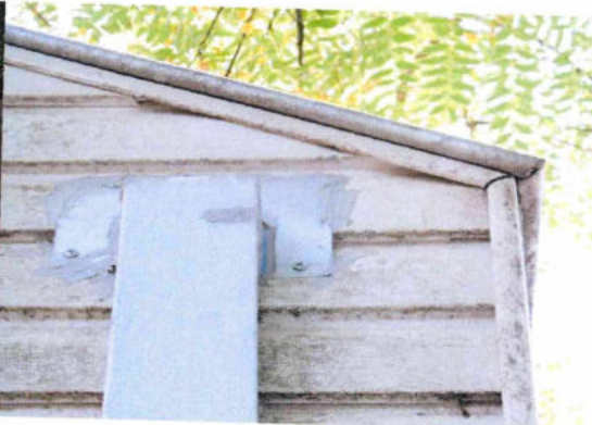
7.56. Condutores d'água pluvial instalados rente à Fachada Sul do imóvel.
