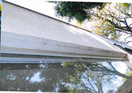
7.18. Fissuração generalizada no requadro do vão do fechamento em vidro na Fachada Oeste.
