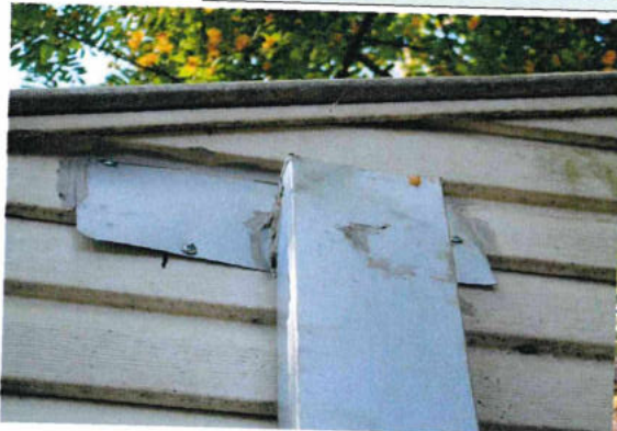
7.51. Condutores d'água pluvial instalados rente à Fachada Sul do imóvel.
