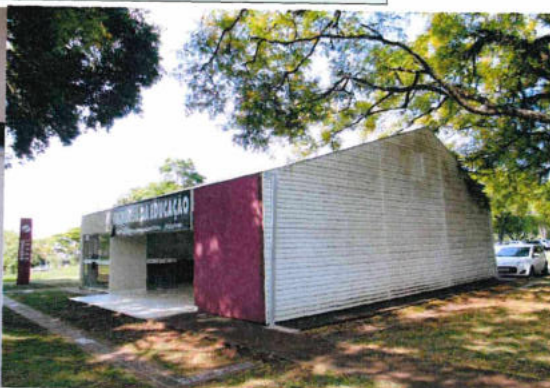
7.46. Condutores d'água pluvial instalados rente à Fachada Sul do imóvel.
