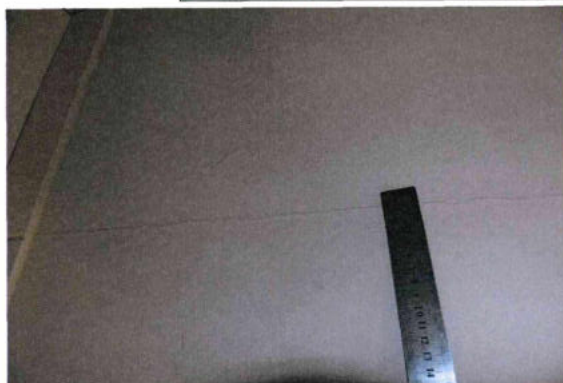
7.39. Fissura vertical na parede da Circulação em frente à porta do Lavabo Masculino.
