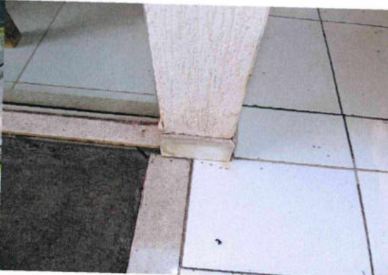
7.20. Marcas de infiltração com desbotamento do esmalte do roda-pé cerâmico junto ao vão do fechamento em vidro na Fachada Oeste.
