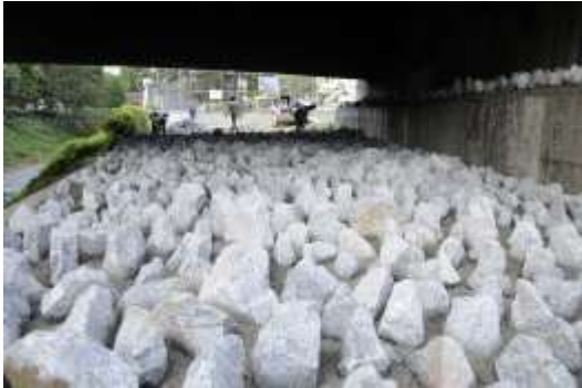
Foto 1: Pedras sob viaduto
