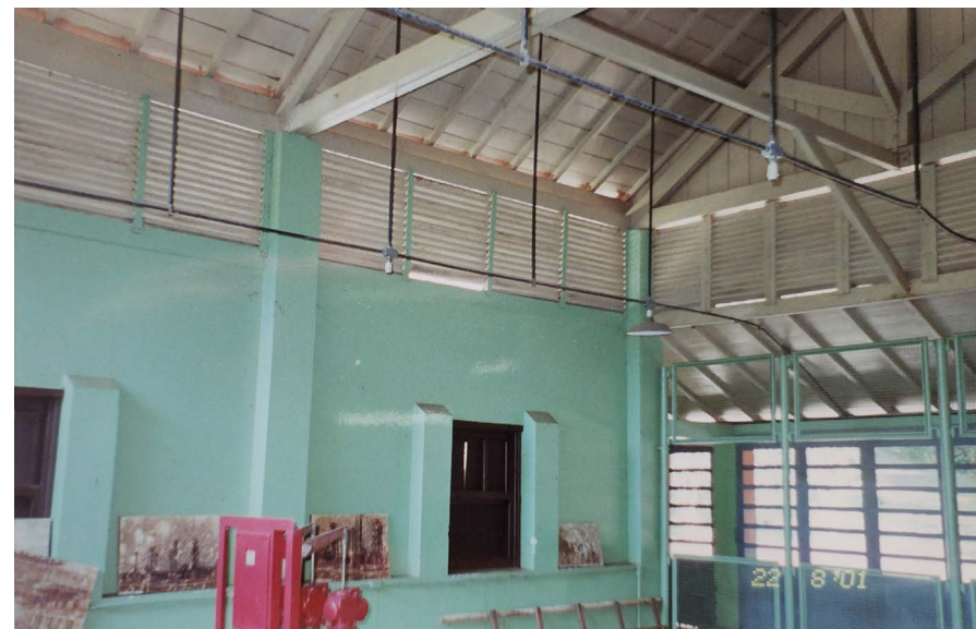
Figura 63 – Área interna da casa de máquinas, 2001
