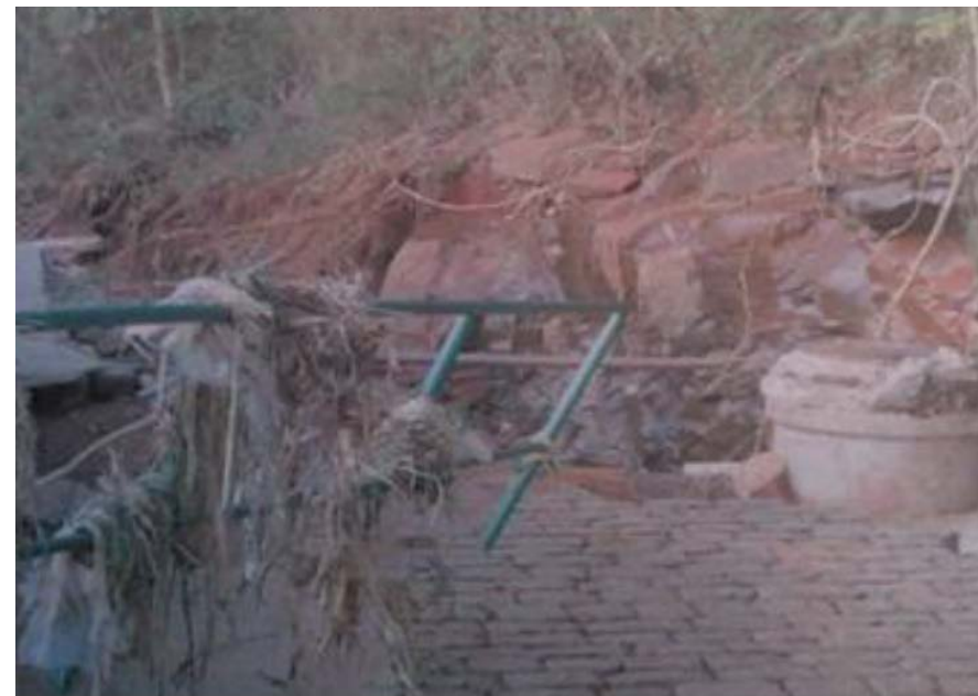
Figura 78 – Danos na pista de caminhada no interior do Parque Arthur Thomas, 2011
