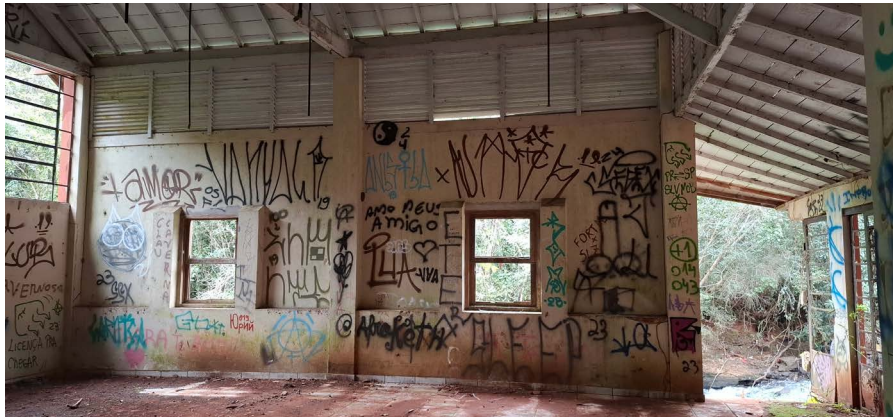
Figura 106 – Vista interna da casa de máquinas, 2025
