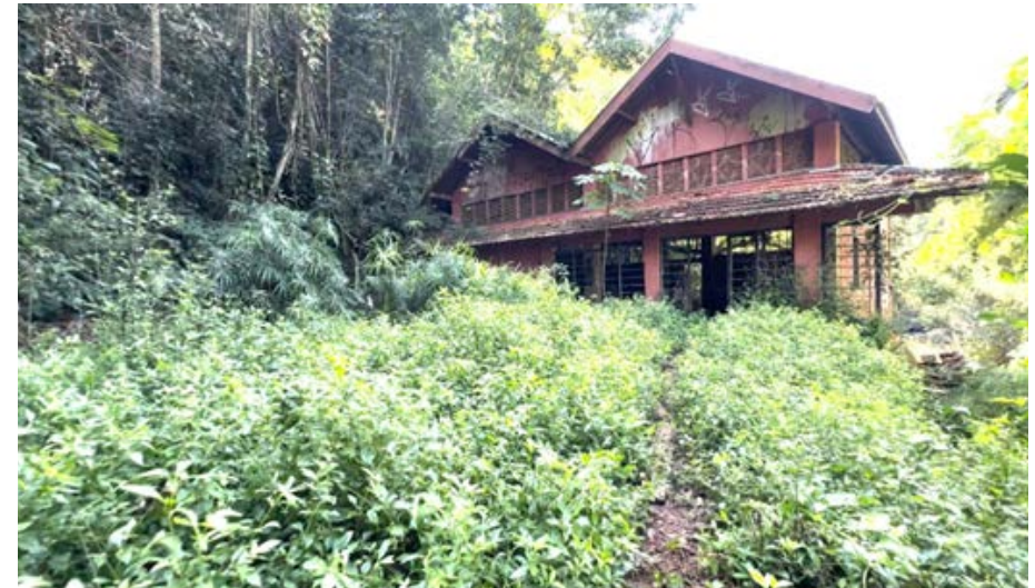
Figura 86 – Casa de máquinas, 2024
