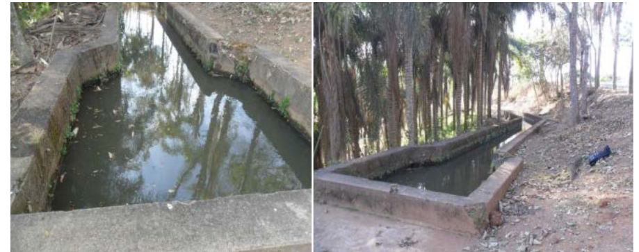
Figura 9 – Câmara de carga da Central de Geração Hidrelétrica Armando Barbosa
