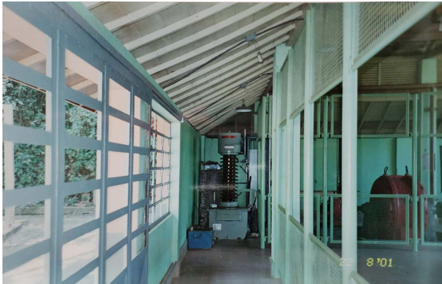
Figura 64 – Área interna da casa de máquinas, 2001
