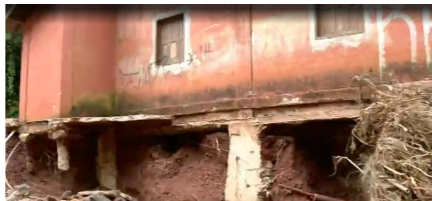
Figura 82 – Estrutura da Usina do salto do Cambezinho danificada pelas chuvas de 2016
