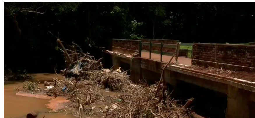
Figura 81 – Barragem da Usina do salto do Cambezinho danificada pelas chuvas, 2016
