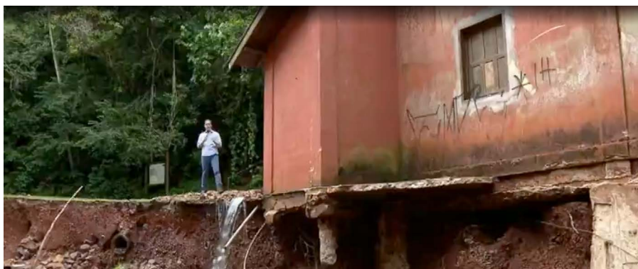
Figura 83 – Estrutura da Usina do salto do Cambezinho danificada pelas chuvas de 2016
