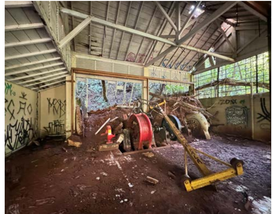
Figura 88 – Vista interior da casa de máquinas, 2024
