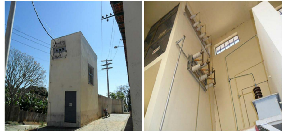
Figura 15 – Casa de força da Central de Geração Hidrelétrica Armando Barbosa
