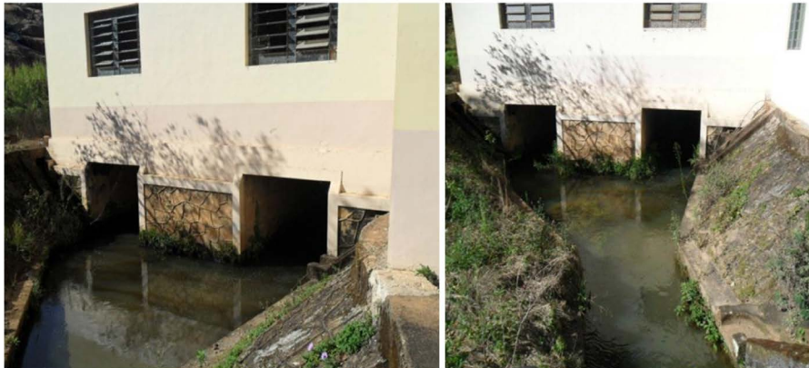
Figura 14 – Canal de fuga da Central de Geração Hidrelétrica Armando Barbosa
