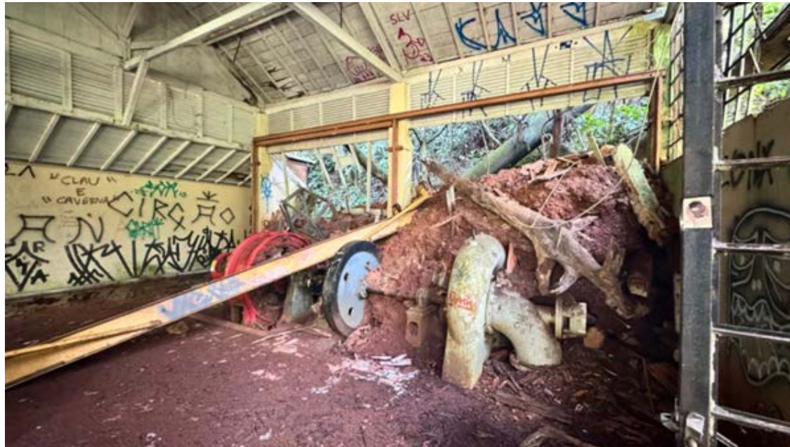
Figura 89 – Vista interna da casa de máquinas, 2024
