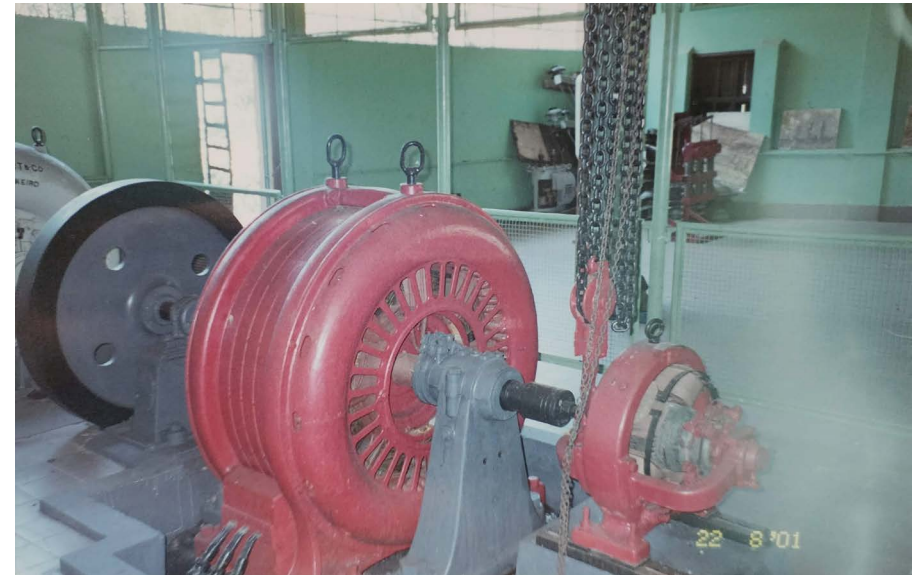
Figura 61 – Área interna da casa de máquinas, 2001
