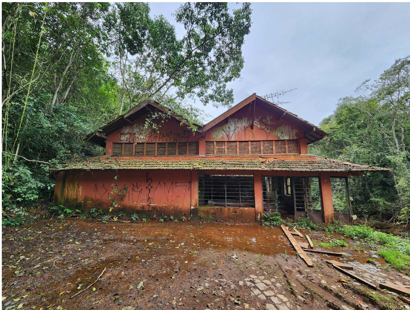
Figura 102 – Estado atual da casa de máquinas, 2025
