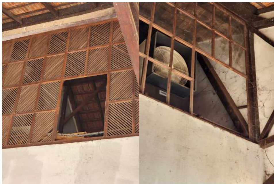
Figura 176 - Patologia Veneziana de Madeira e esquadria superior de madeira.
