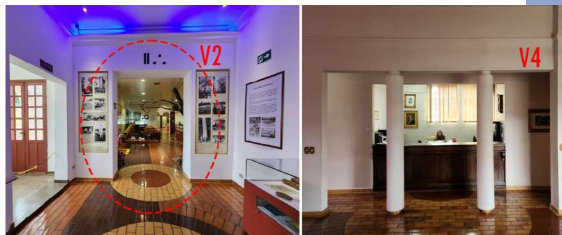
Figura 98 — Fotos dos vãos V2 e V4 que não foram executados conforme o projeto arquitetônico proposto de 1985.
