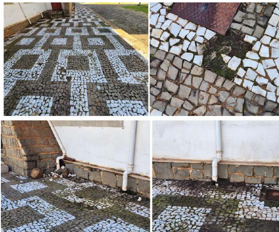
Figura 177 - Patologia Piso Petit-Pavet.
