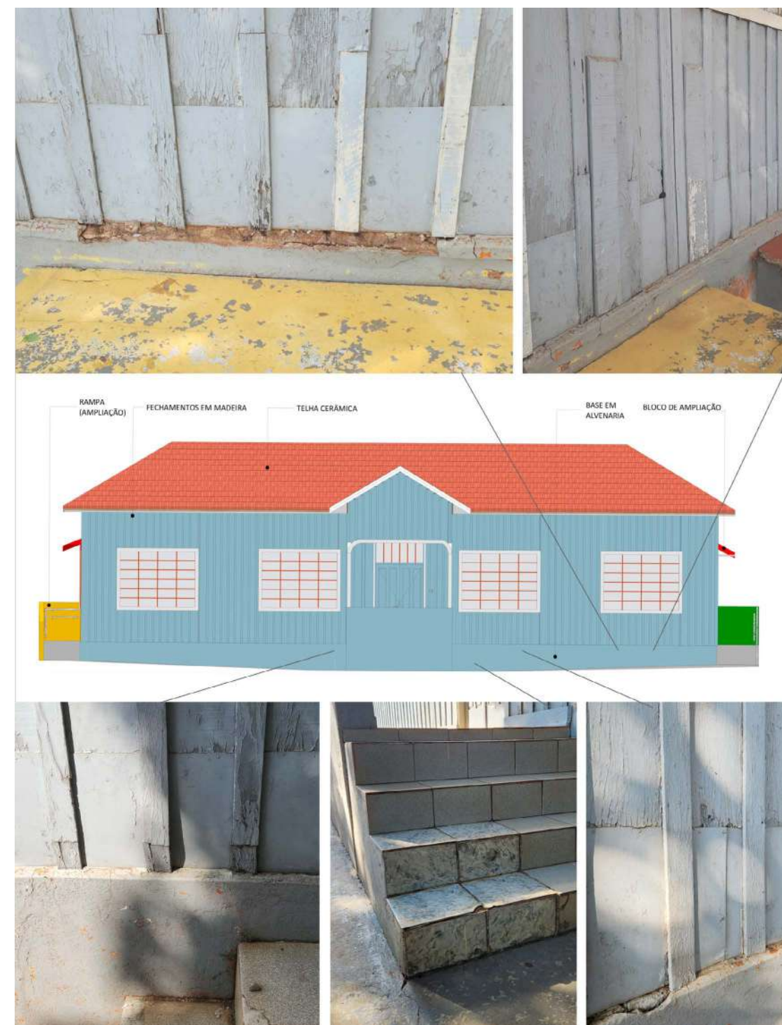
figura 87 - Patologias da fachada frontal da Escola Municipal Padre Anchieta.
